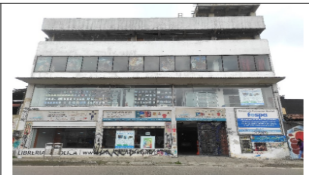
Foto 2. Se evidencia que el elemento publicitario fue desmontado
